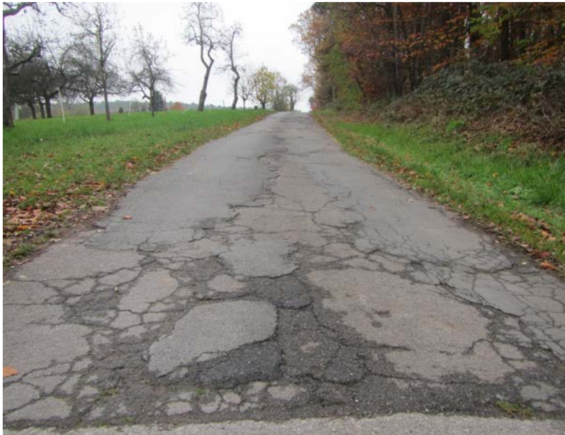
Abbildung 11-2: Oberflächenmängel auf dem Weg nach Klotzenhof
