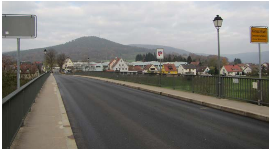
Abbildung 4-4: Die Nebenanlagen auf der Mainbrücke entsprechen nicht mehr den heutigen Standards
