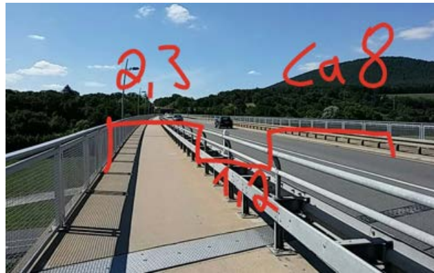
Abbildung 3-2: Nebenanlage auf der Martinsbrücke entspricht nicht den Standards und der Nachfrage
