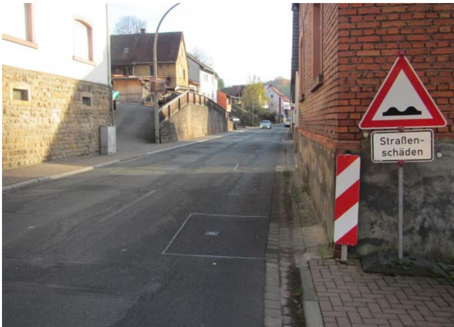
Abbildung 19-1: Ortsdurchfahrt in schlechtem Zustand
