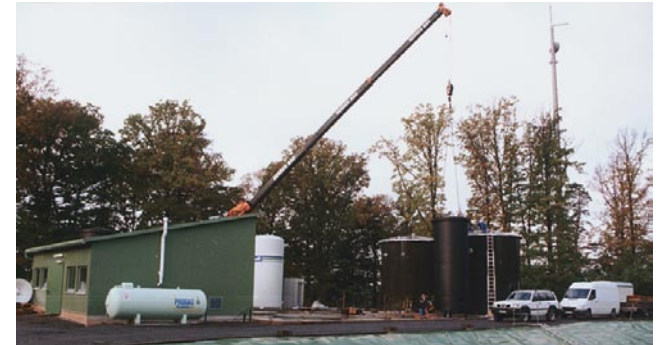
Aufstellung der Behälter und Speicher
